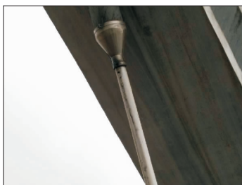
图4 吊杆上锚头腐蚀渗水
