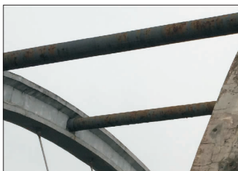
图3 横撑钢管锈蚀
