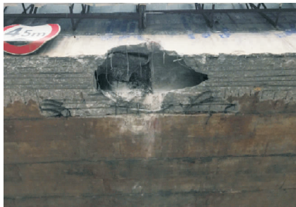
图 3 受撞后 2—9# 空心板损伤情况
