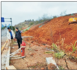
图 4 道路设施的隆起破坏
