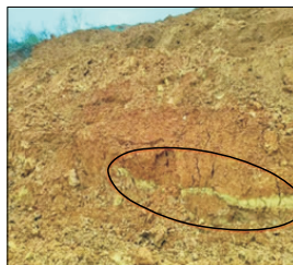
图1 坡脚土岩界面处软弱夹层
