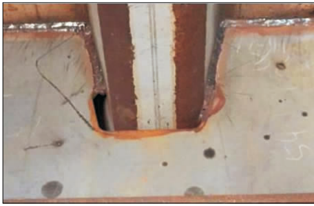
图3 横梁U形槽口左右两边间隙不对称
