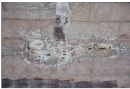
图2 引桥空心板底病害
