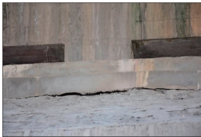
图 6 护坡下沉开裂
