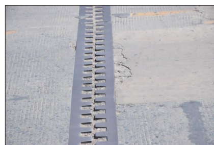
图 10 伸缩缝堵塞、锚固区混凝土破损
