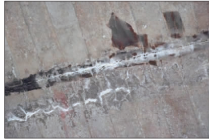
图3 铰缝开裂渗水
